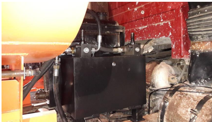
Шкаф гидрооборудования с гидробаком.
